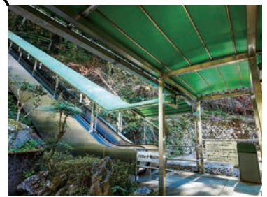
龍河洞入口エスカレーター/参道の階段に併設されたエスカレーター
